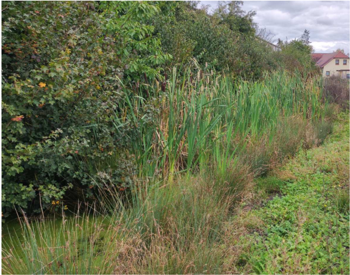
Abbildung 3: eingerutschte Böschung, Pkt. 2
